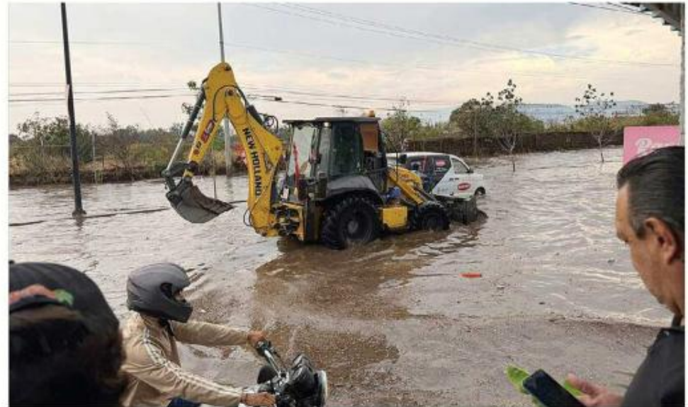
■ Los puntos con más problemas por inundaciones son el cruce con Guadalupe Gallo y Camino Real, en la parte sur; y hacia el norte en la Avenida Bahía de Todos Santos.
