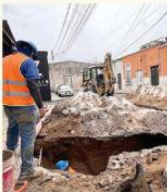
■ Acude personal del SIAPA a reparar el hundimiento.
