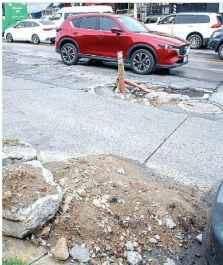
■ Aunado a la fuga sobre la Calzada Federalismo, se formó un socavón a unos metros.
