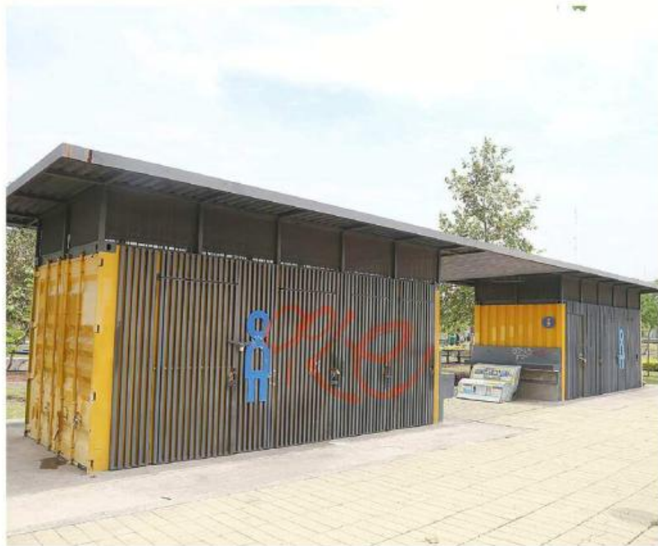
Los baños no funcionan; usuarios y vecinos aseguran que así han estado siempre.
