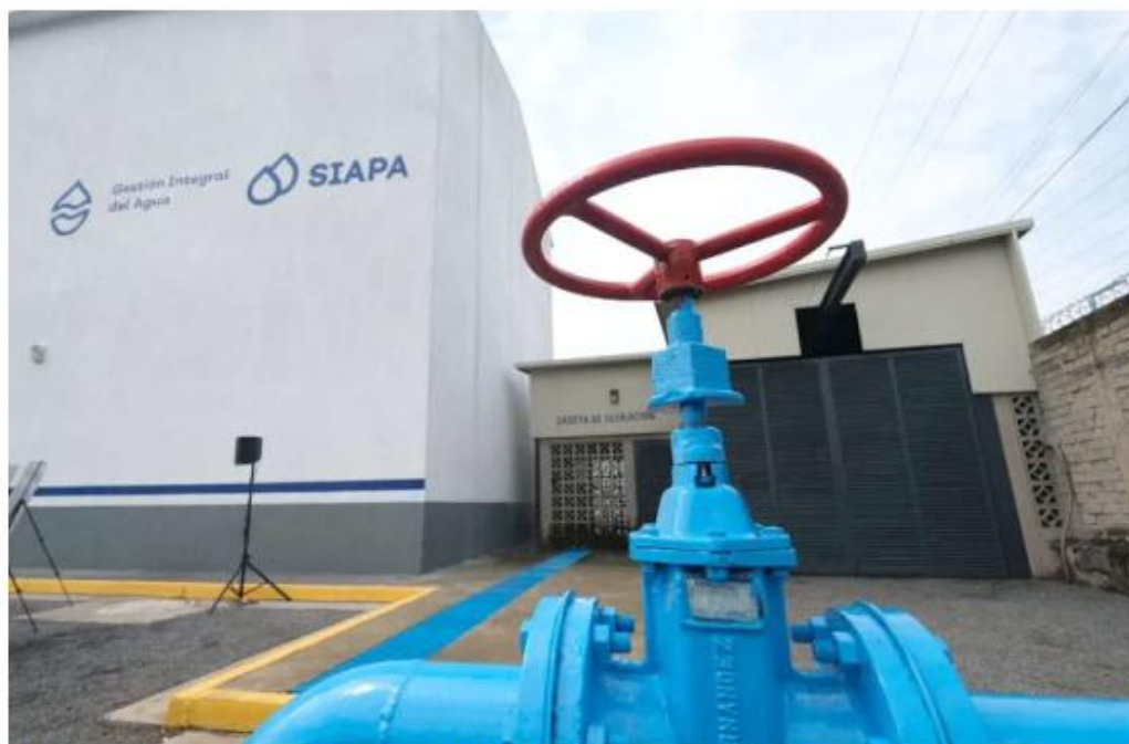
Con 70 años de operación, la Planta Potabilizadora Miravalle es la más antigua. CORTESÍA: SIAPA
