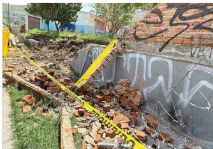
La Escuela Primaria Manuel Gomez Morín, ubicada en Tlajomulco, presentó afectaciones.
