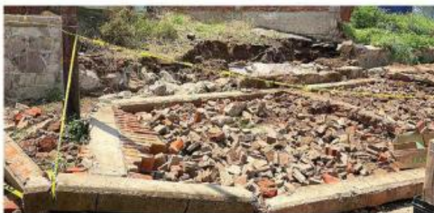
■ Producto de la lluvia, el 11 de julio, al menos 12 viviendas resultaron inundadas y se cayeron bardas perimetrales en escuelas.
