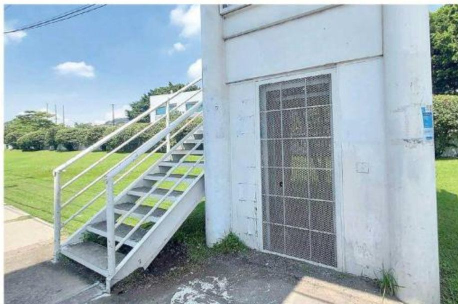
■ En el puente peatonal ubicado a la altura de San José del Tajo, el elevador está fuera de servicio.
