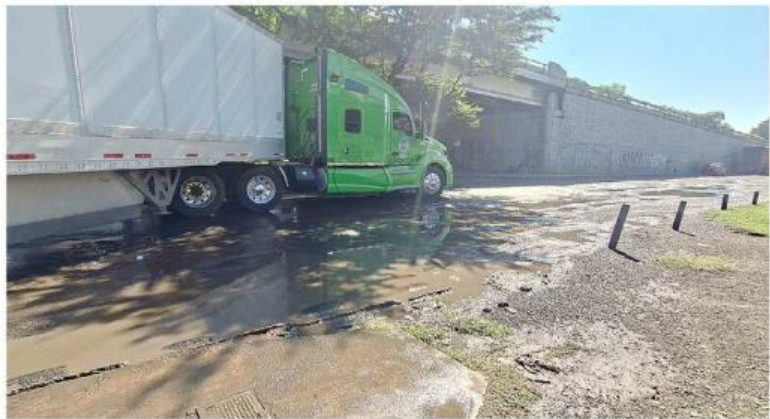
Entre lluvias y tráileres acabaron con el bacheo reciente a la altura del Álamo.
