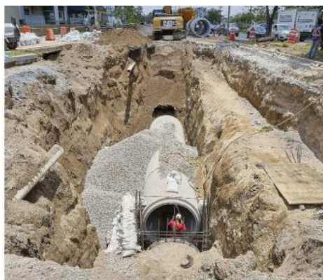
La vía fue cerrada desde el 17 de julio tras la aparición de un socavón.
