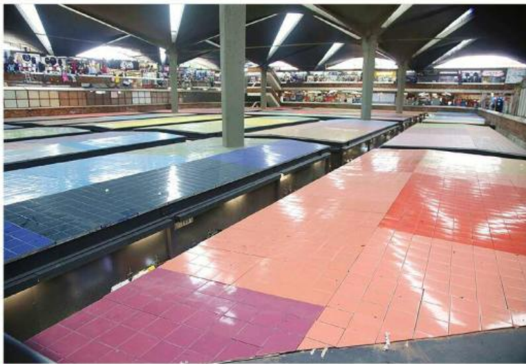
El Gobierno de Guadalajara informó que se sustituirán las piezas de mosaico dañadas.
