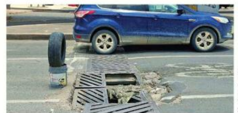
■ A una alcantarilla le falta la tapa, por lo que se alerta a los conductores con unas llantas.
