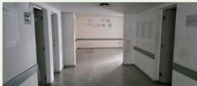
La unidad presenta un deterioro estructural severo tras más de 60 años de antigüedad.
