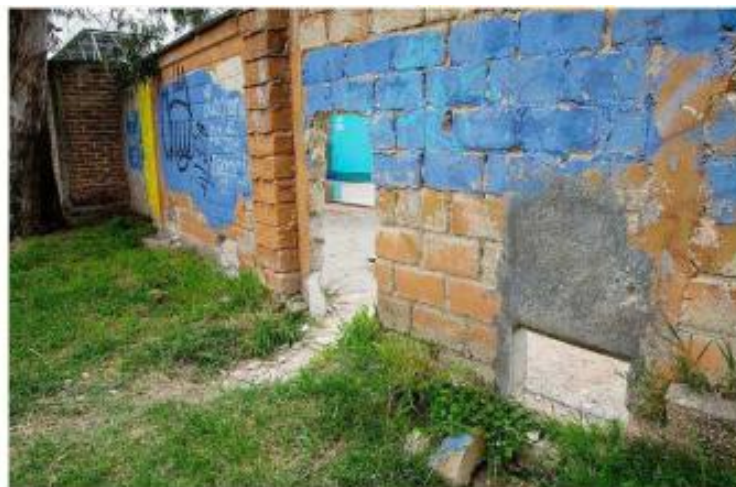
■ La barda que divide los fraccionamientos Parques del Bosque y Haciendas de San José, tiene grietas, desprendimiento de material y hasta riesgo probable de caída.
