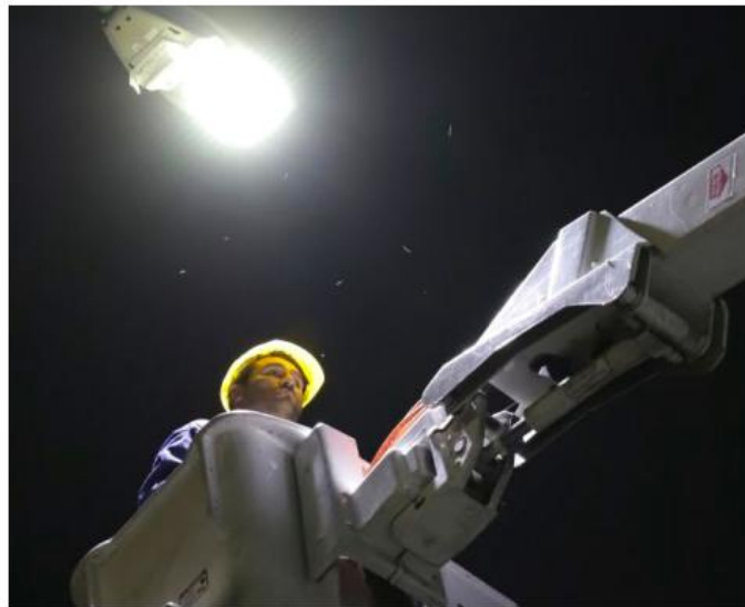
Se instalaron 2 mil 559 nuevos puntos de luz, entre luminarias viales y reflectores.
