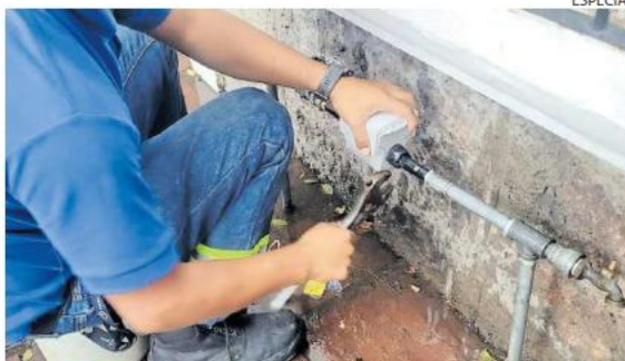
RECONEXIÓN. El Centro Cultural El Refugio tiene agua de forma parcial.
