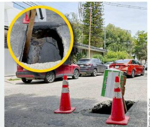
Vecinos colocaron conos para alertar a conductores sobre el hundimiento.
