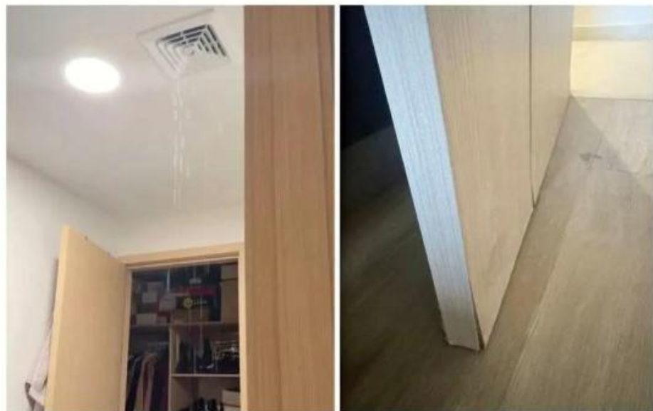
■ Se reportan problemas por filtraciones en techos y paredes de los departamentos de esta torre ubicada en Colomos Providencia.
