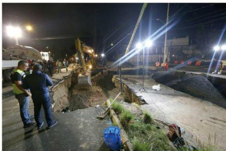
■ Por la tarde creció el socavón, afectando más carriles.
