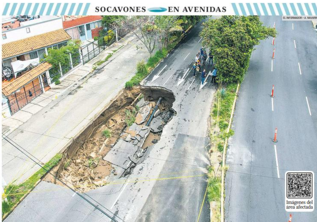
JARDINES DEL COUNTRY. Colonos de la zona viven con temor ante la aparición de tres socavones en la Avenida Enrique Díaz de León en menos de dos semanas. El SIAPA advierte que podrían surgir más debido a la antigüedad de la infraestructura hidrosanitaria.
