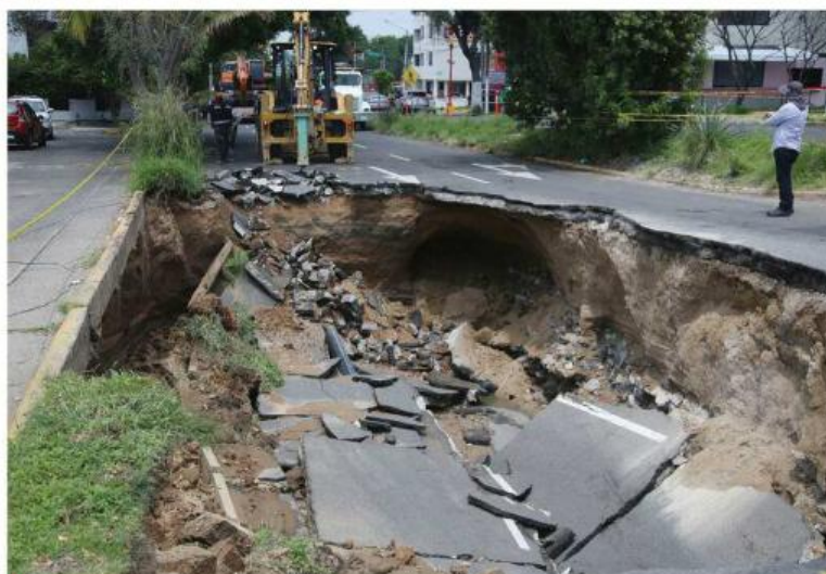
■ El hundimiento mide 15 metros de largo y seis metros de ancho, con una profundidad de 2.5 metros.
