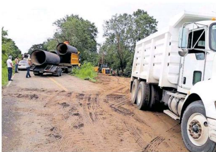
Ya se reparan los caminos afectados por las lluvias. CORTESÍA.
