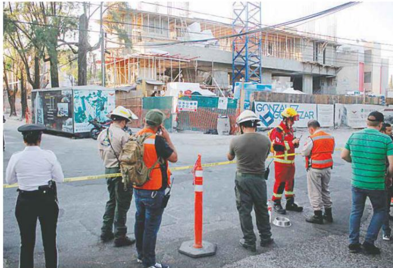
PROBLEMAS. La torre Alara Montevideo, ubicada en la colonia Colomos Providencia, colapsó parcialmente en marzo pasado.
