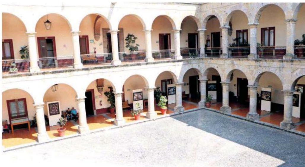
El edificio en el que laboran requiere mantenimiento y ya recibió recomendaciones de la CEDH. FOTO: AGAPITO ESPINOZA
