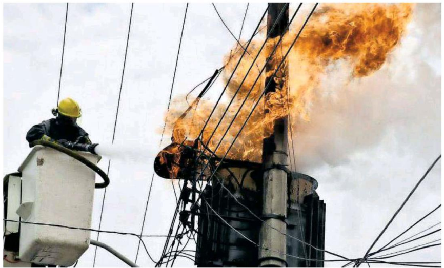
Un corto circuito habría ocasionado que el transformador ardiera en llamas. CORTESÍA
