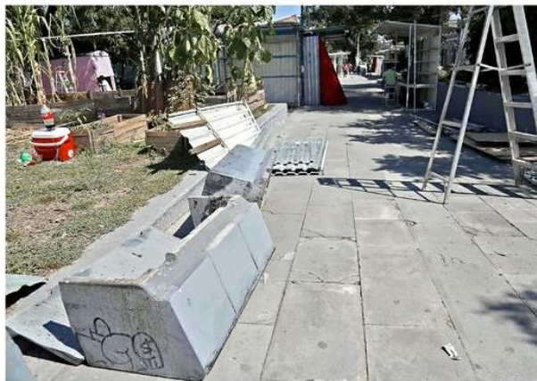
Algunas estructuras están dañadas, así como bancas, losas y el tablero de basquetbol.
