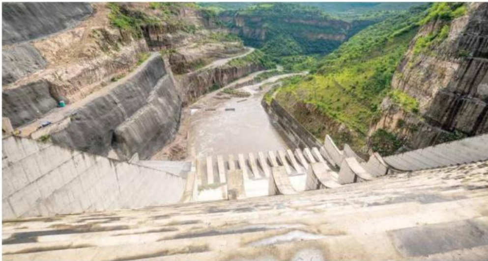
MEGAPROYECTO. La ASF encontró irregularidades por más de 30 millones de pesos en la construcción de la presa.
