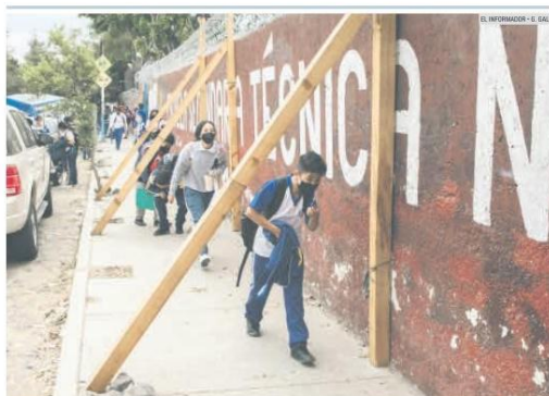
RIESGO. La barda principal de la Secundaria Técnica 13, ubicada en Atemajac del Valle, fue apuntalada para evitar que se venga abajo. Padres de familia y estudiantes piden a las autoridades que rehabiliten el plantel antes del próximo temporal.
